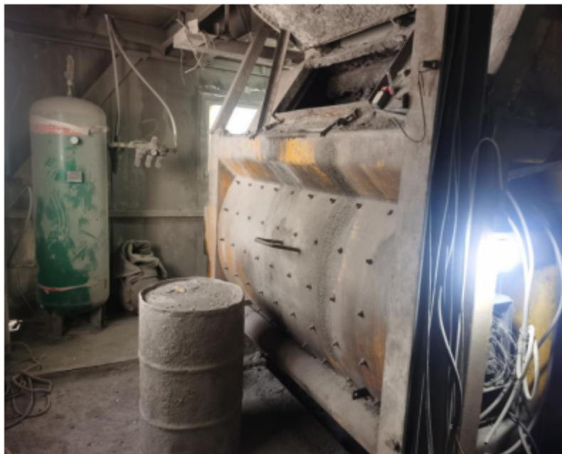
(发生事故的2号搅拌机拌筒)
