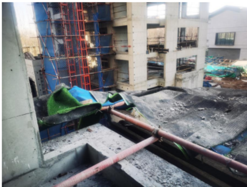
(伤者坠落终点处-3层窗外防护网)
