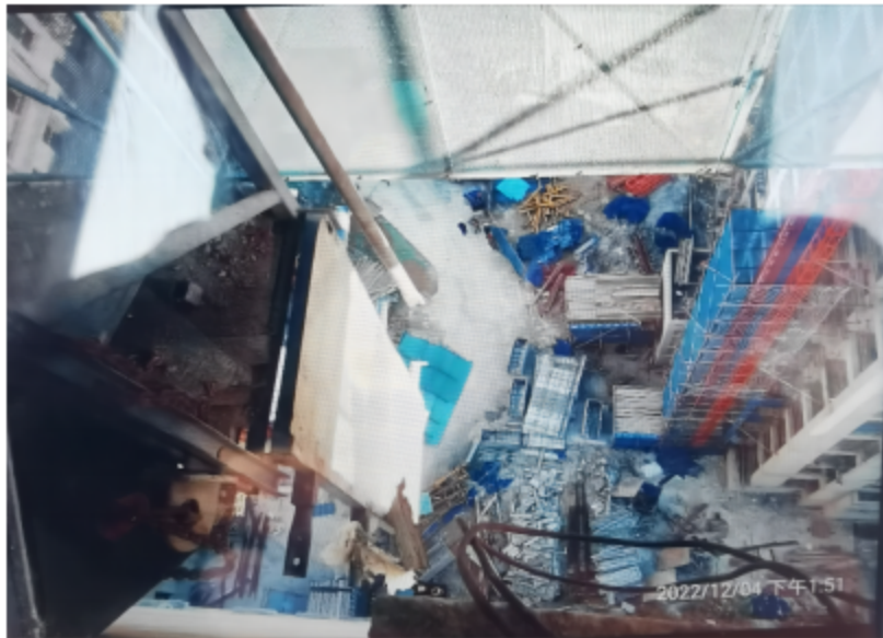
(伤者坠落起点处-14层至15层爬架作业平台)
